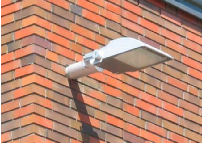
Verlichting aan gevel, detectie
